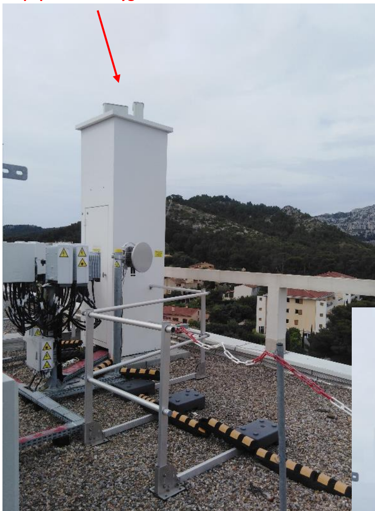
Equipement Bouygues existant
